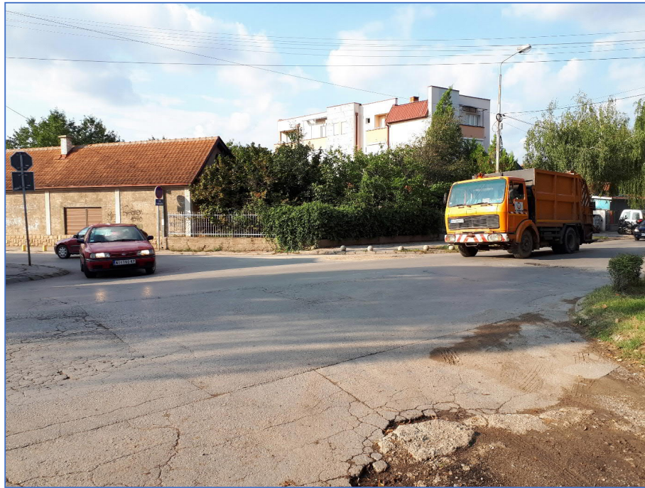
SLIKA 11.14: Primećeni prekidi na površini puta na ulici u Nišu
