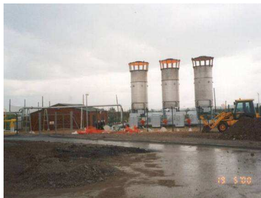
Слика 6.36. Искоришћење депонијског гаса за добијање електричне енергије у Великој Британији
